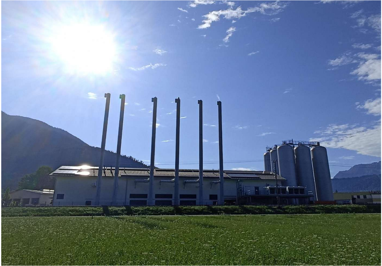
Blockheizkraftwerke und Wärmespeicher der Gemeindewerke
